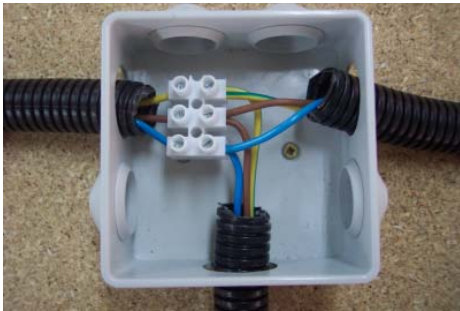
Detalle de la derivación hasta la toma de corriente
