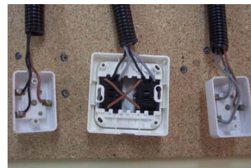
Detalle de las conexiones
