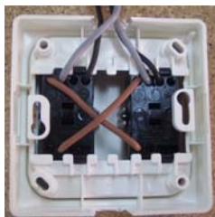
Detalle de las conexiones del conmutador de cruce
