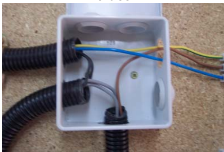
Detalle de los hilos del circuito
